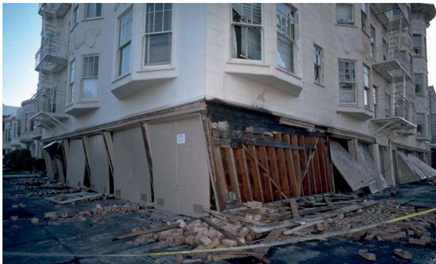
شکل ۱-۱. مثالی از خسارت سازه‌ای در یک ساختمان با دیوارهای برشی ضعیف در طبقه پارکینگ. زلزله لوماپریتا ۱ ، سن فرانسیسکو ۲ ، ایالات متحده. ۱۹۸۹.
